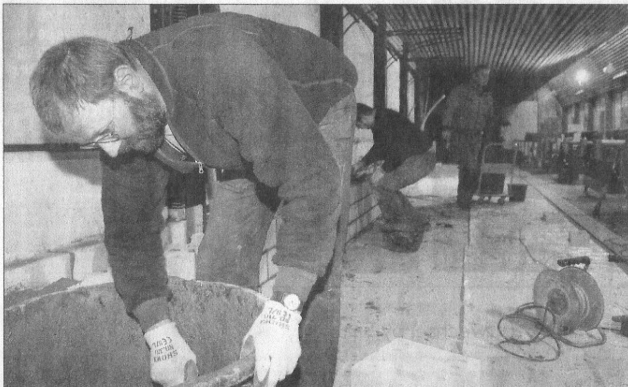
Arbeiter (im Bild Sepp Odermatt) sind derzeit daran, den 300-Meter-Schiessstand in Stans baulich den Lärmvorschriften anzupassen.
